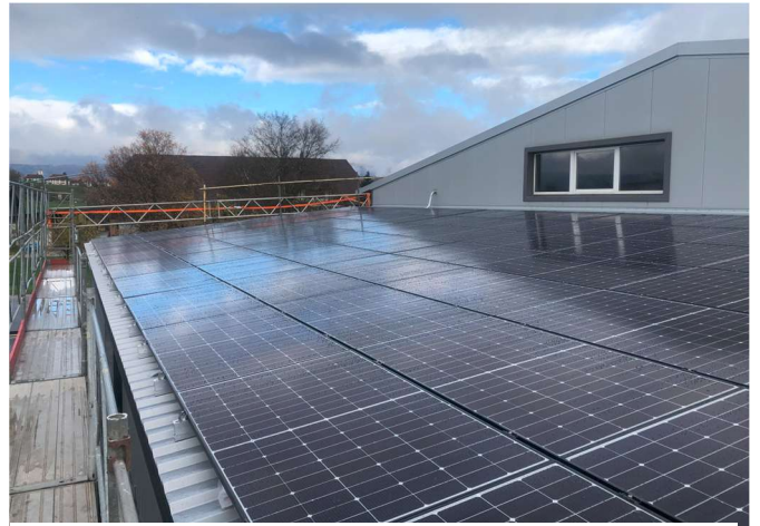
Dachanlage Meyer Burger White
